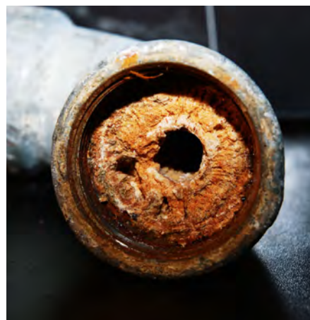
» OBRÁZEK Vápenné usazeniny v potrubí pitné vody
