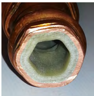
Měděné potrubí s povlakem vápenných usazenin
